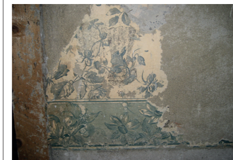
Die Renovation bringt es an den Tag: Resten einer Wandtapete von ca. 1880.
