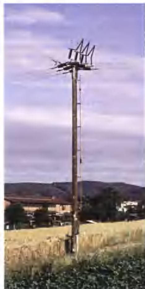
Der an der Noteinspeisung liegende Mastschalter, heute noch Norm. Foto Mutti
