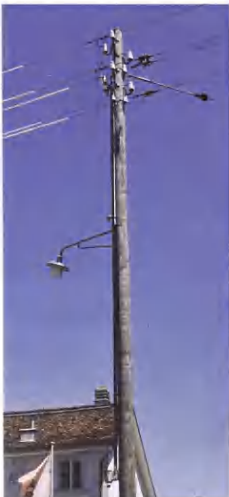
Zur Zeit die letzte noch in Funktion stehende Freileitung für Sekundärstrom im Dorf mitsamt einem noch funktionierenden Dreschanschluss an der Schützenmauerstrasse, westlich der ehemaligen Hintergasse. Foto Mutti
