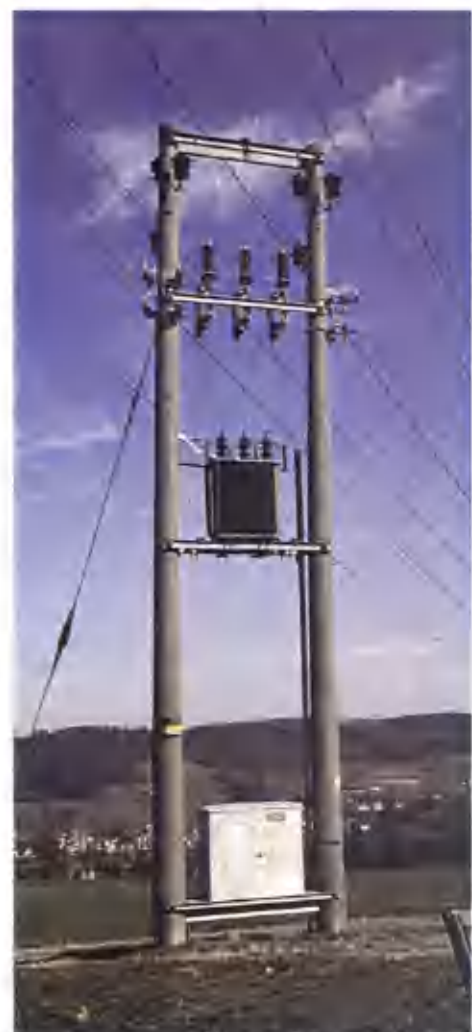
Als Abschluss des Kapitels noch eine Stangen-Trafostation. Hier diejenige auf dem Kymenhof. Foto Mutti
