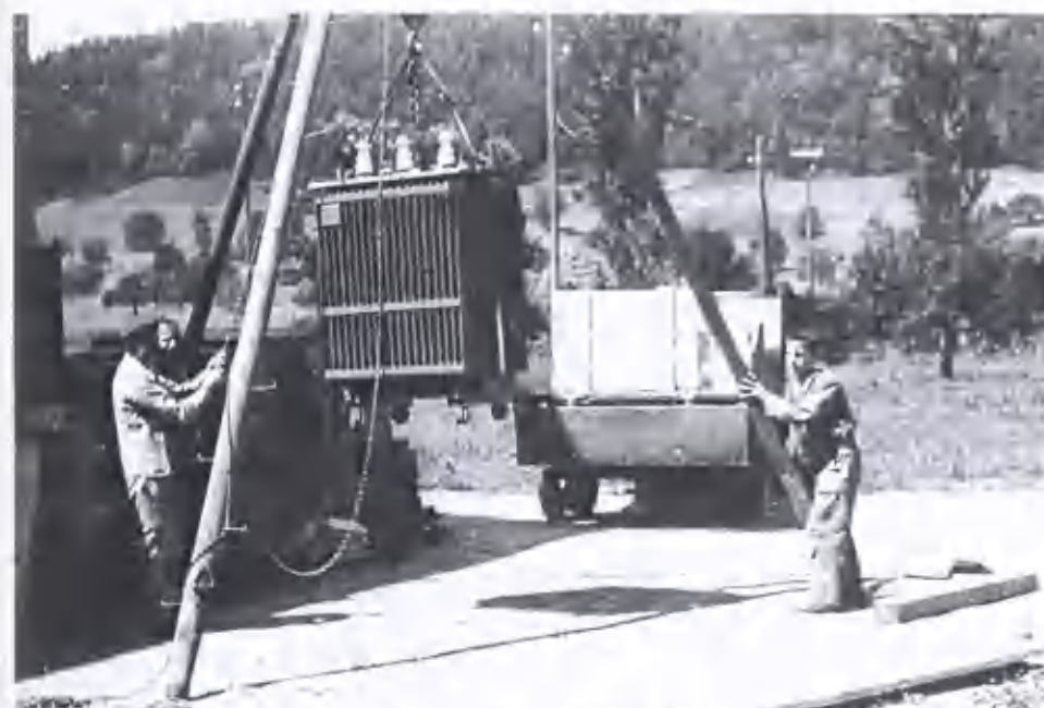
Gottfried Ganz (ganz links) mit Lehrling Staufer (rechts) beim Trafoablad neben der Mess- und Schaltstation 1956. Bild Frau B. Ganz
